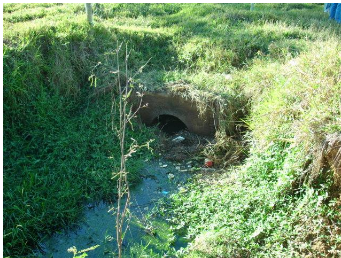
Tubulação de saída das águas pluviais, vindos do piscinão, com 1,0m de diâmetro, lançados num dos braços do rio Paraná.
