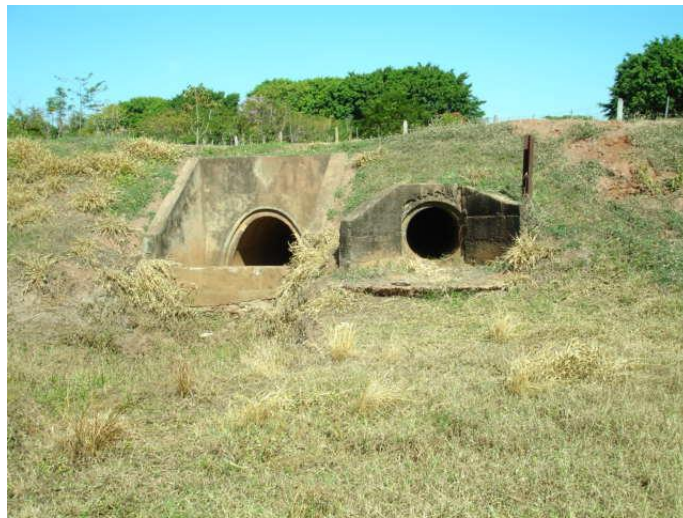
Saída das águas pluviais do lago artificial (piscinão)
