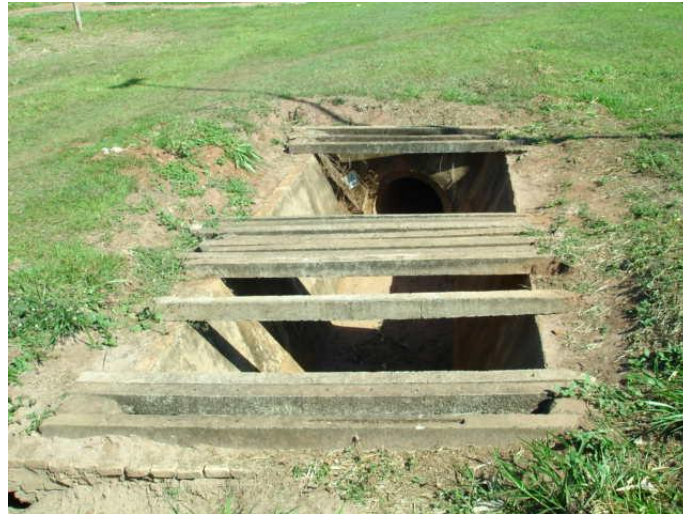
Caixa de passagem que faz ligação com a tubulação de saída do lago artificial (piscinão) – sub-bacia G
